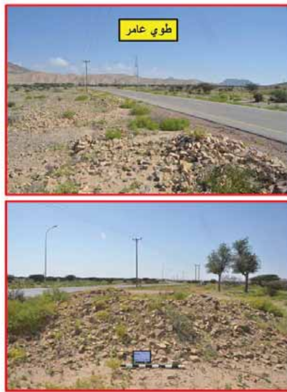
الشكل ١٤: مجموعة من القبور المتضررة من جراء إنشاء طريق مسفلت في منطقة طوي عامر.
